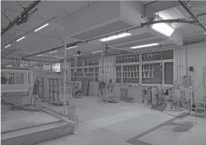
Tauchanlage, Fördersystem, Zuluftfilterdecke für Raumbelüftung.
