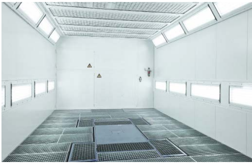
Die Kabine sollte mindestens 4 x 7 m Grundfläche aufweisen. LED-Leuchten verbrauchen wesentlich weniger Strom.
